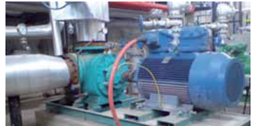
1 7 Pompa rozładunkowa i ładunkowa L4NG
