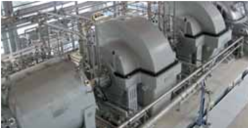
1 Pompa oleju smarowego i uszczelniającego do sprężarek L3
