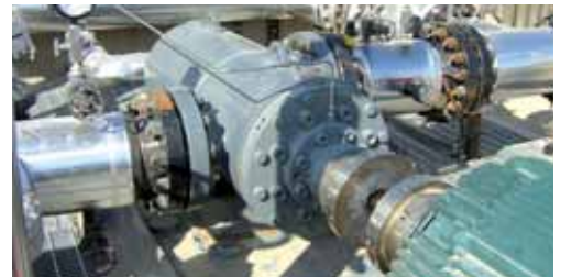
4 Pompa przeładunkowa L3MG
