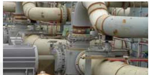
3 Pompa ładunkowa i przeładunkowa L4NG
