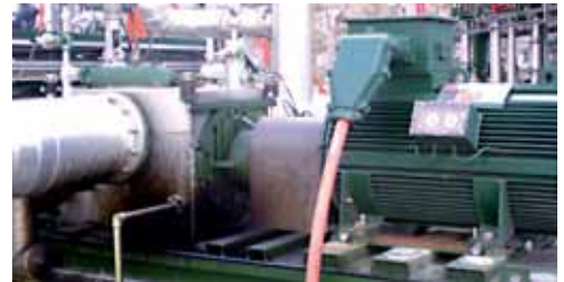
1 Pompa rozładunkowa L4MG
